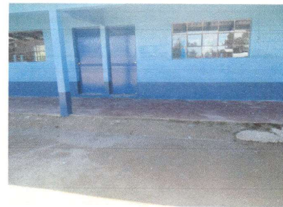
Foto 4: Estado actual de la pintura
