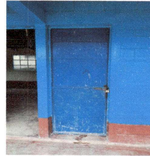
Foto 2: Estado actual de las puertas
