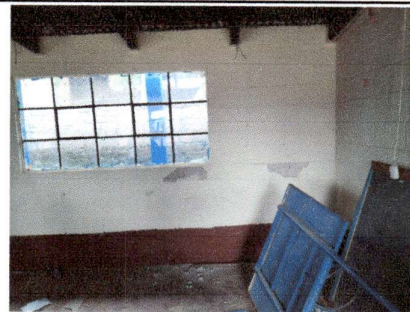
Foto 6: Estado actual de la pared de las aulas dentro y fuera
