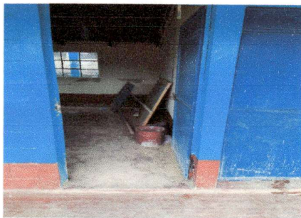
Foto 3: Mal estado de piso
